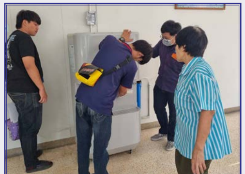
▶ ติดตั้งตู้น้ำระบบเซนเซอร์
