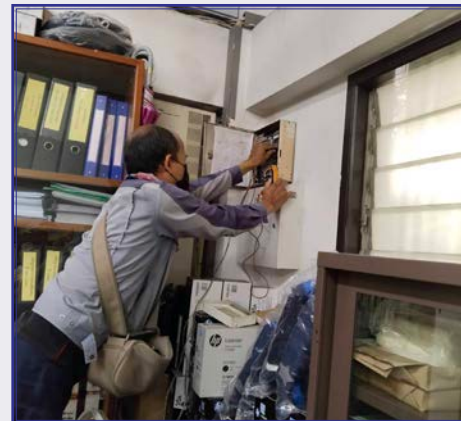
▶ ตรวจสอบระบบสัญญาณ เตือนภัยฉุกเฉิน และแจ้ง 191
